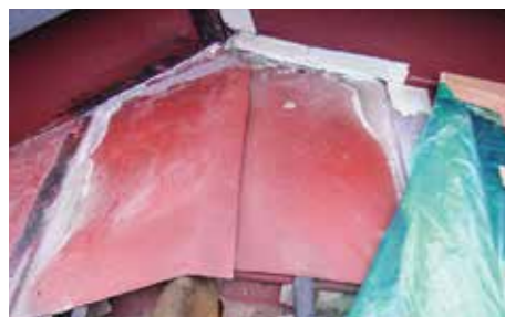
構造要因：接合部分の変形
