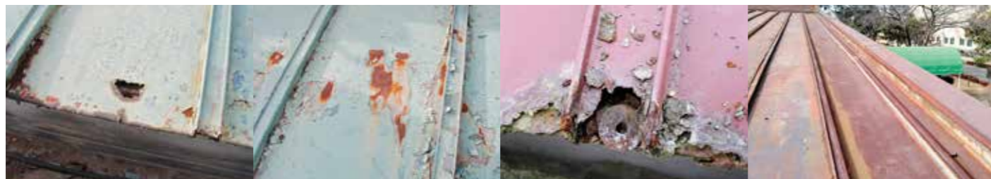
塗膜要因：錆の進行による腐食
