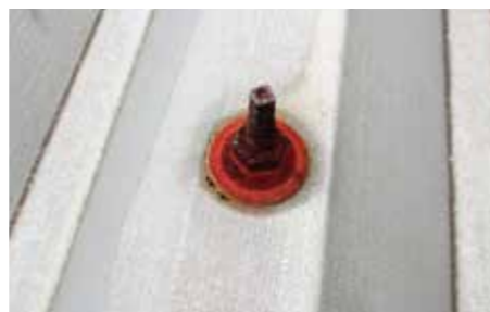
部材要因：ボルトの腐食
